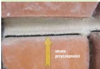
Odspojenie zaprawy od elementu mурowego – otwarcie drogi dla wody
