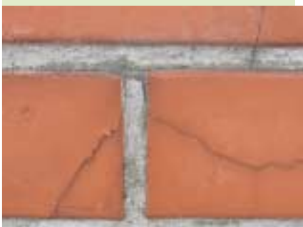
Pęknięcia elementu mурowego: najtrudniejsze do naprawy otwarcie drogi dla wody
