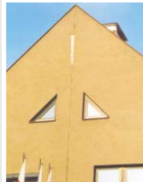
Pęknięcie zewnętrznego cienkowarstwowego tynku polimerowego na ociepleniu ściany dwuwarstwowej – otwarcie muru na zawilgocenie
