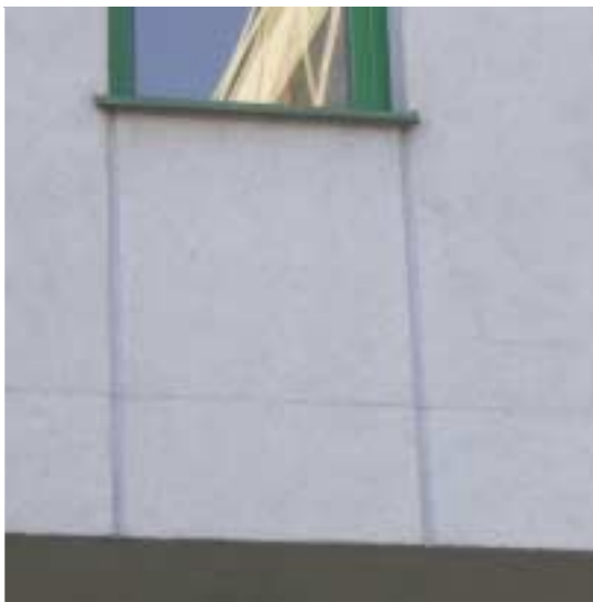
Pęknięcie zewnętrznego cienkowarstwowego tynku polimerowego na ścianie jednowarstwowej – otwarcie muru na zawilgocenie
