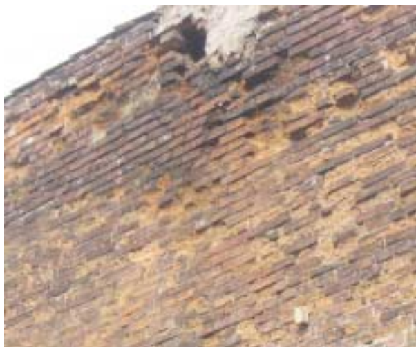
Destrukcja cegły na ścianie ze zbyt mocną zaprawą o mniejszej paroprzepuszczalności niż element murowy (cegła)
