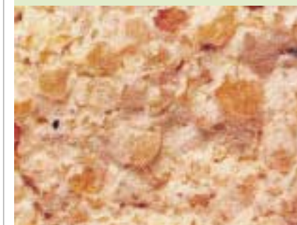
Mniej porowata struktura zaprawy zawierającej wapno
