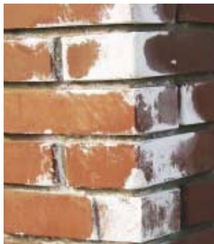
Wykwity na elewacji z cegły ceramicznej
