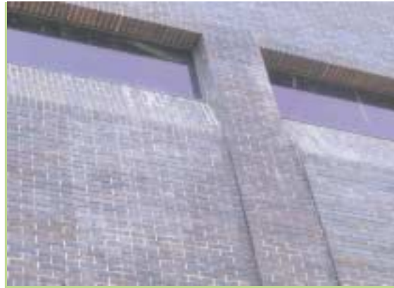
Wykwity na płytkach elewacyjnych układanych na mrozoodpornym kleju bez dodatku wapna hydratyzowanego
