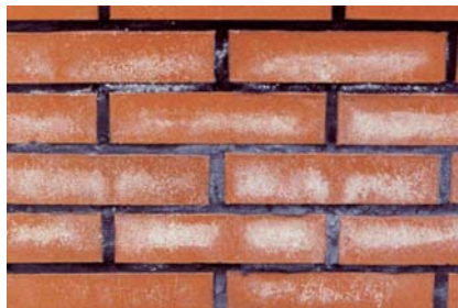
Zdjęcie 2. Zaprawa o mniejszej przepuszczalności niż cegła spowodowała powstanie wysoleń na licach cegieł.
