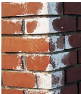
Zdjęcie 1. Białe wysolenia na cegle powstają również wtedy, gdy w zaprawie nie ma wapna.
