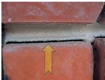
Zdjęcie 3. Utrata przyczepności zaprawy do podłoża. Została otworzona ścieżka dostępu wody do wnętrza muru.
