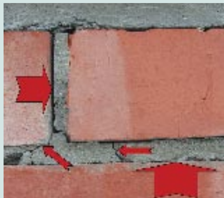
Zaprawa cementowa z niewłaściwie skomponowaną domieszką napowietrzającą jest sztywna i krucha. Łatwo pęka.
