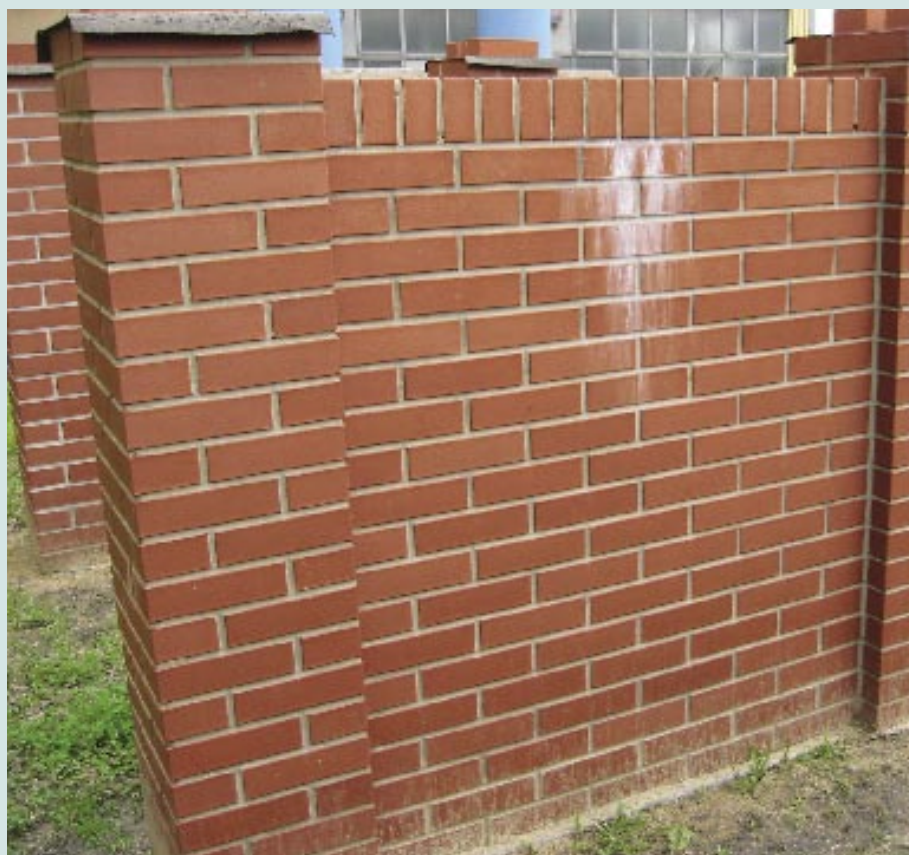
Mur testowy. Widoczne są często spotykane wykwity solne.
