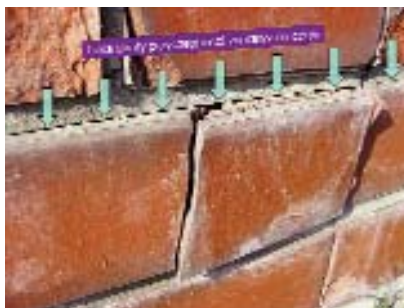
Fot. 1. Stosowanie mocnych, lecz słabo przyczepnych zapraw cementowych z plastyfikatorem grozi poważnym uszkodzeniem muru
