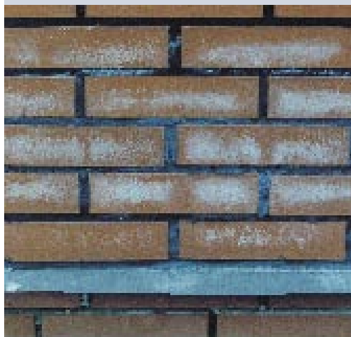
Widoczne białe osady spowodowane transportem soli na powierzchnię cegieł
