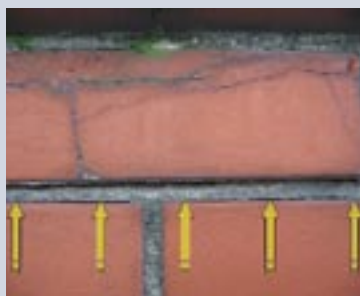
Zastosowanie domieszki napowietrzającej spowodowało utratę przyczepności zaprawy do cegły
