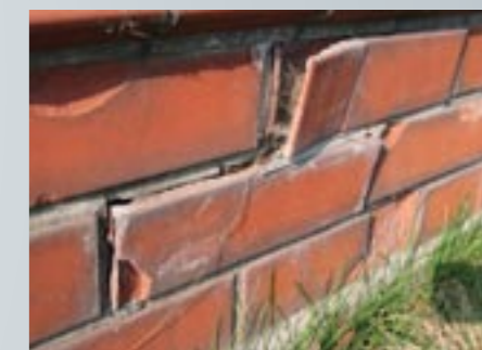
Fot. 3. Im mocniejsze zaprawy, tym szybciej mur degraduje. Wystarczyły cztery lata od zakończenia prac murarskich, aby mur zaczął się „sypać”.
